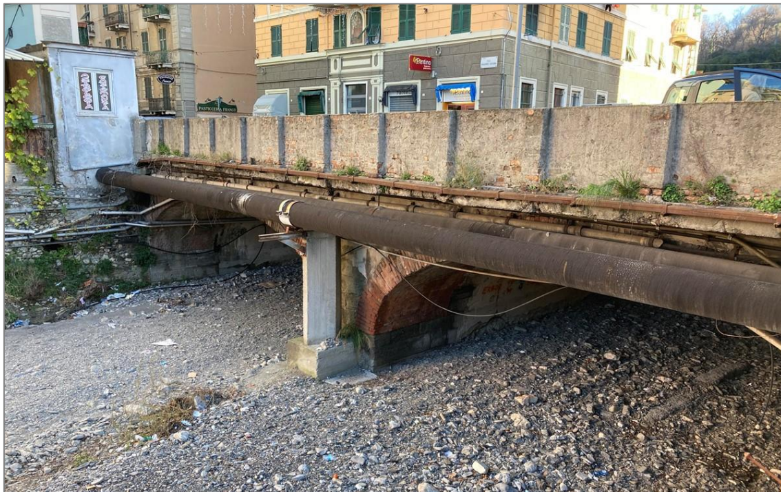
Figura 3-8: Condotte del gas sul lato di valle del ponte di via Canepari
