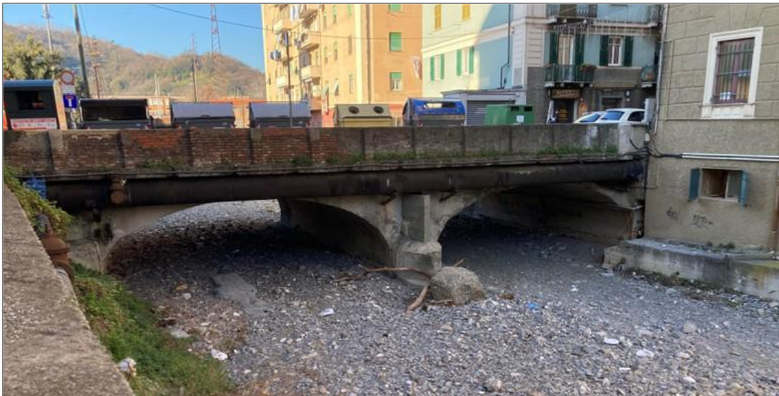
Figura 3-7: Vista da monte del ponte di via Canepari, con il rostro centrale e la condotta dell'acquedotto staffata
