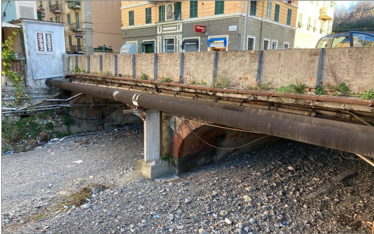
Figura 2-15: Condotte del gas sul lato di valle del ponte di via Canepari
