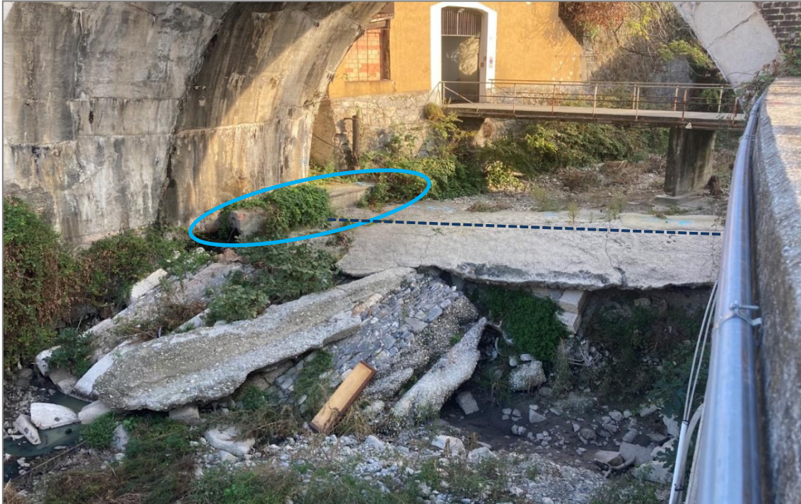
Figura 2-8: Salto di fondo del t. Torbella a monte rispetto alla confluenza con il t. Polcevera. il bauletto della fognatura bianca sfocia propria in prossimità di questo salto, dove evidenziato con l'ellisse in azzurro. Si evidenzia inoltre la condotta di acquedotto DN500 che si trova al di sotto della soglia in cemento
