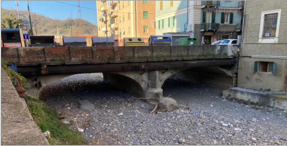
Figura 2-4: Condotta dell'acquedotto ancorata sul lato di monte del ponte di via Canepari
