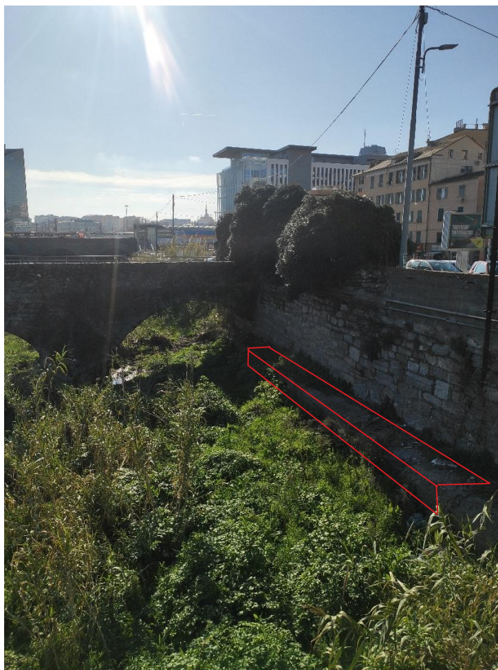
Figura 5. Fognatura in area golenale in sponda destra del torrente Bisagno
