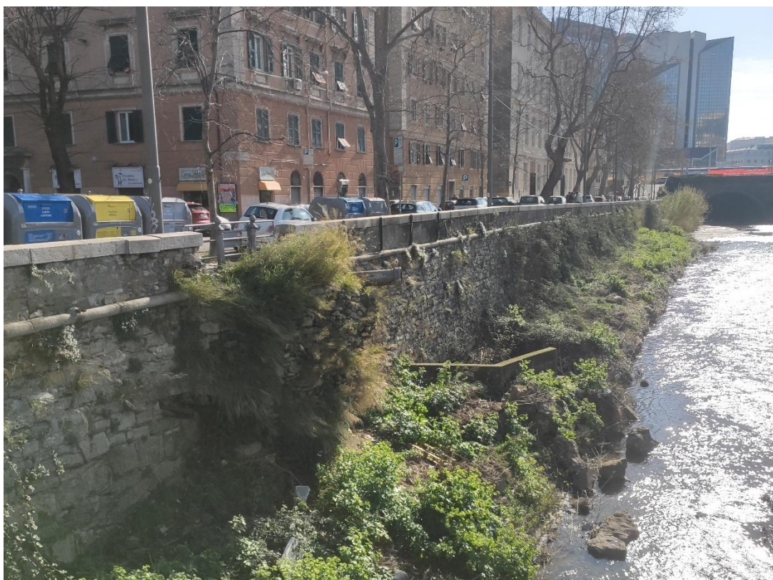
Figura 4. Tubazione trasporto fanghi staffata all'argine in sponda sinistra del torrente Bisagno
