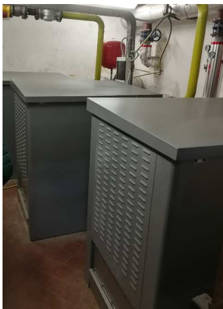
Figura 3.14 – Generatori di calore esistenti Palazzo Ducale
