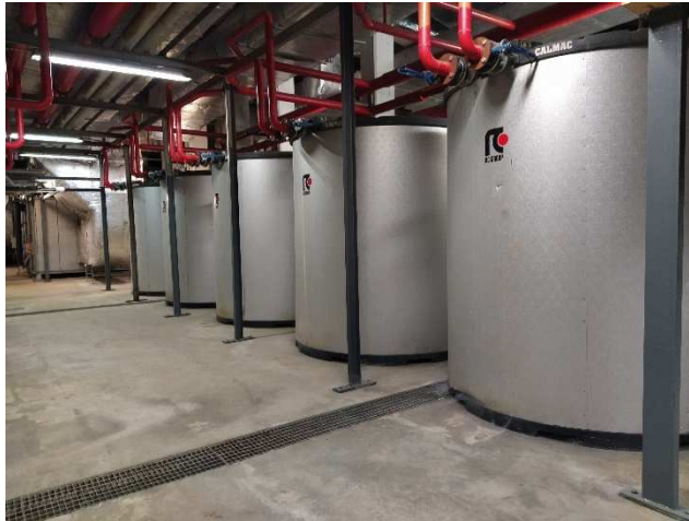
Figura 6.2 - Locale condizionamento sede accumuli termici acqua refrigerata.
