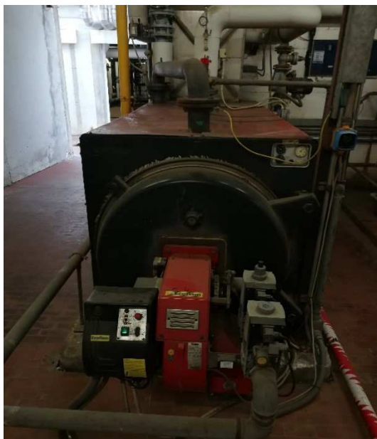
Figura 4.1 – Generatori di calore esistenti Teatro “Carlo Felice”
