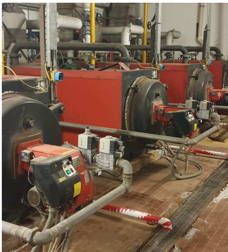
Figura 3.1 – Generatori di calore esistenti Teatro “Carlo Felice”
