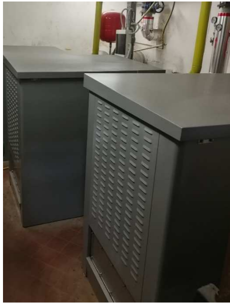
Figura 4.2 – Generatori di calore esistenti Palazzo Ducale
