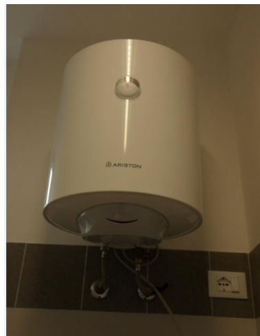
Figura 4.12 - Particolare del boiler di ACS della palestra
