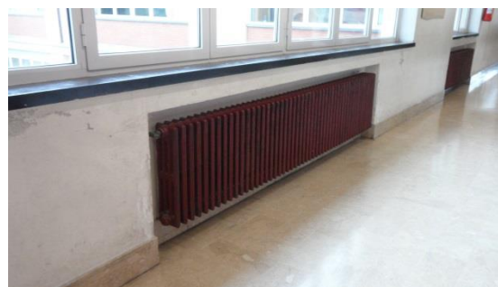
Figura 4.6 - Particolare dei radiatori scuola e aerotermi palestra
