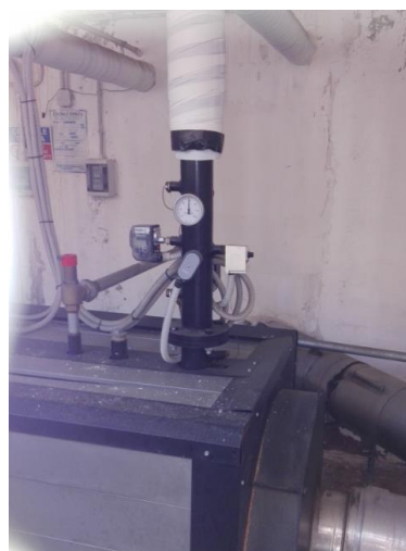
Figura 4.11 - Particolare della caldaia
