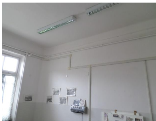
Figura 6.9 - Particolare dei corpi illuminanti attualmente installati
