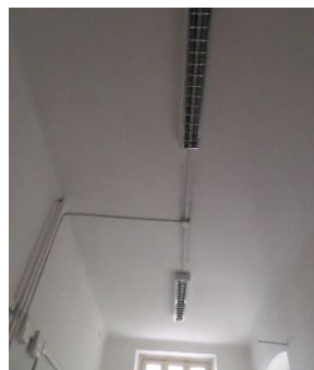
Figura 4.10 - Particolare dei corpi illuminanti ubicati all'ingresso nel corridoio
