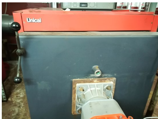
Figura 4.9 - Particolare della caldaia Unical TZ AR 500
