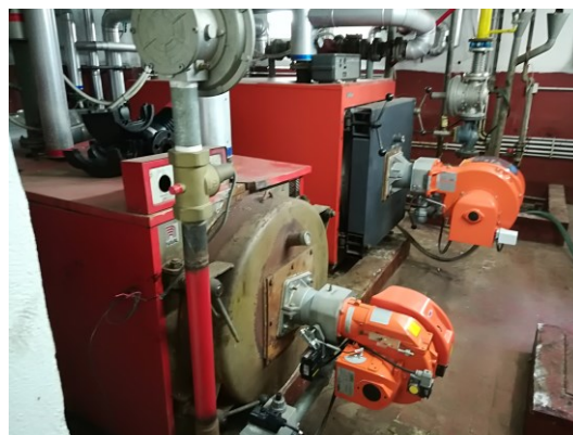
Figura 4.10 - Particolare di entrambe le caldaie
