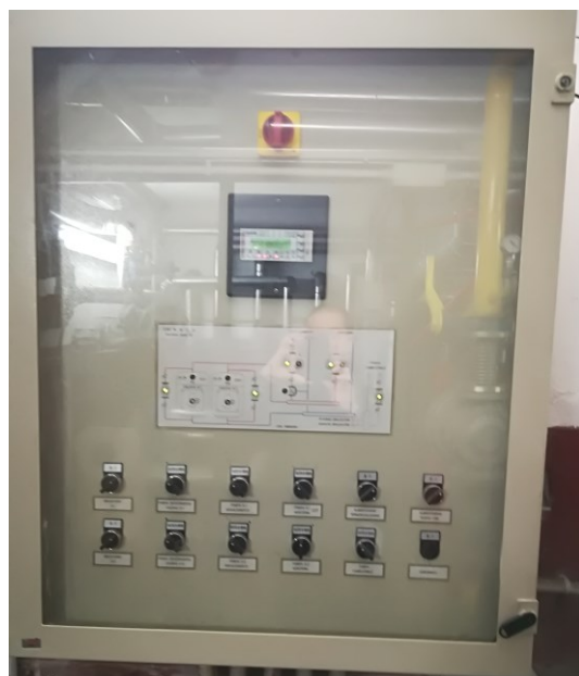
Figura 4.6 - Particolare del pannello di controllo di dell'impianto termico
