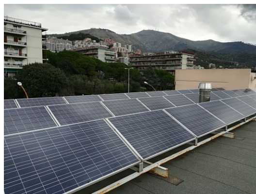
Figura 4.13 - Vista dell'impianto fotovoltaico
