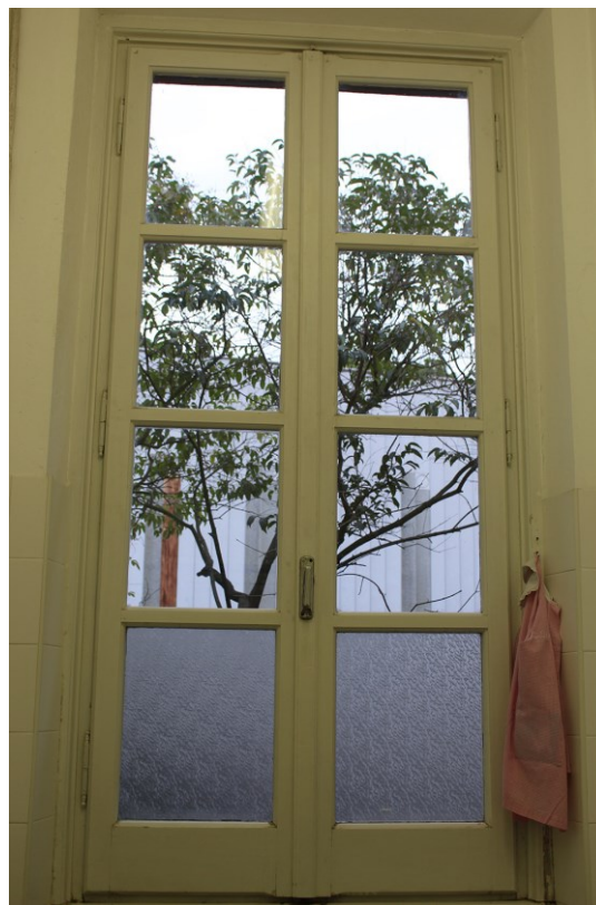
Figura 8.3- Particolare finestra esistente in legno
