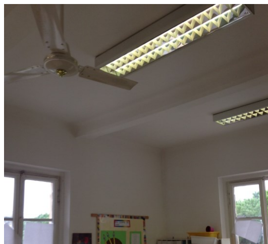
Figura 8.8 - Particolare di una lampada fluorescente attualmente installata
