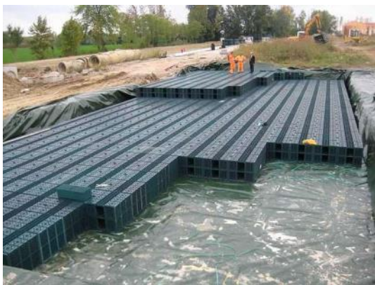
Camere di ritenzione delle piogge
