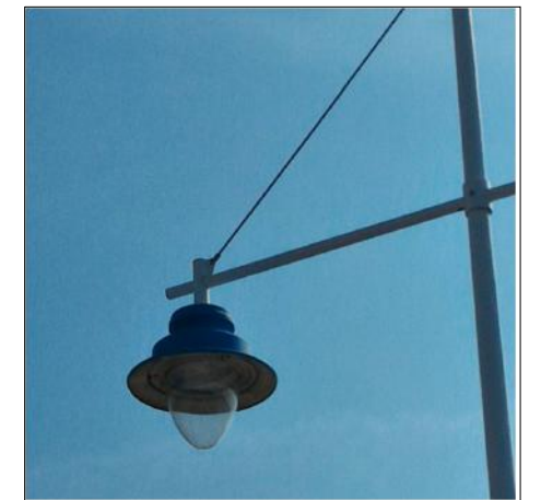
ILLUMINAZIONE FASCIA DI RISPETTO PRA'
